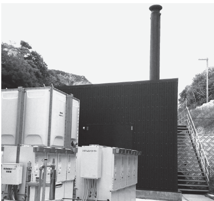
木質バイオマスチップボイラー
